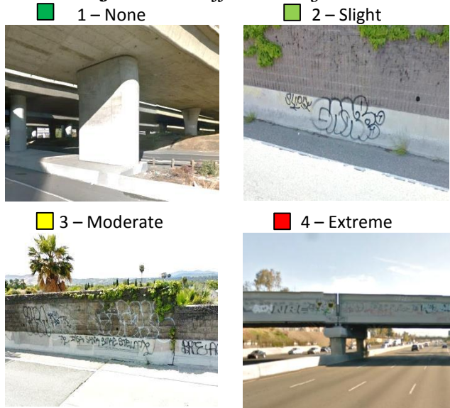
Figure 28. Graffiti Grading Scale.
